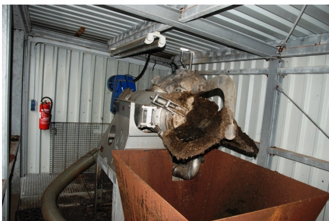
Foto 22: Separatoren. Materialet (det faste) falder ned på beton nedeunder huset.
