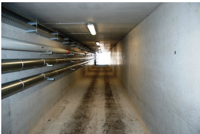
Foto 36: En stejl nedgang fører ned til teknikrummet, der ligger i bunden af et tårn centralt i reaktoren (både primær og sekundær)
