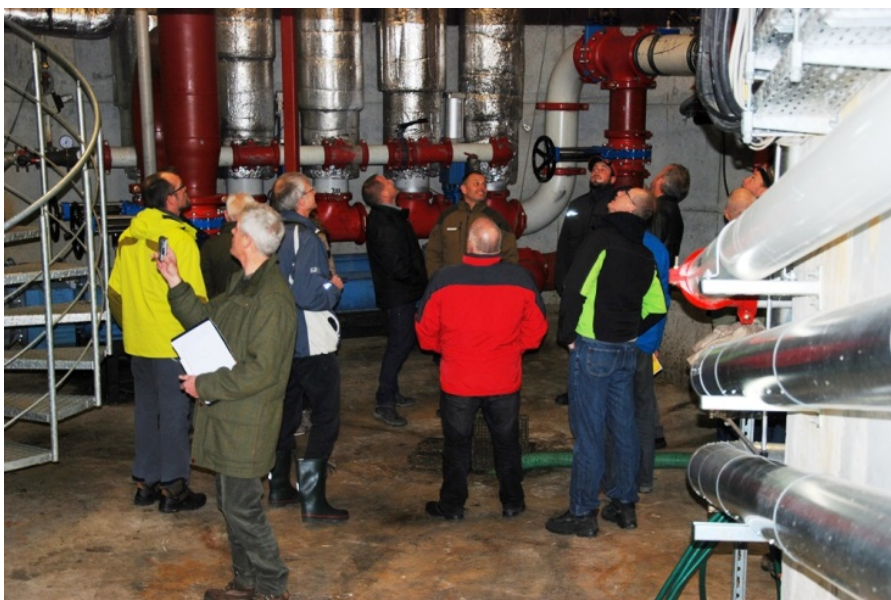
Foto 38: Besigtigelse af teknik- og pumperum. I baggrunden ses de meget store lodretsiddende varmevekslere.
