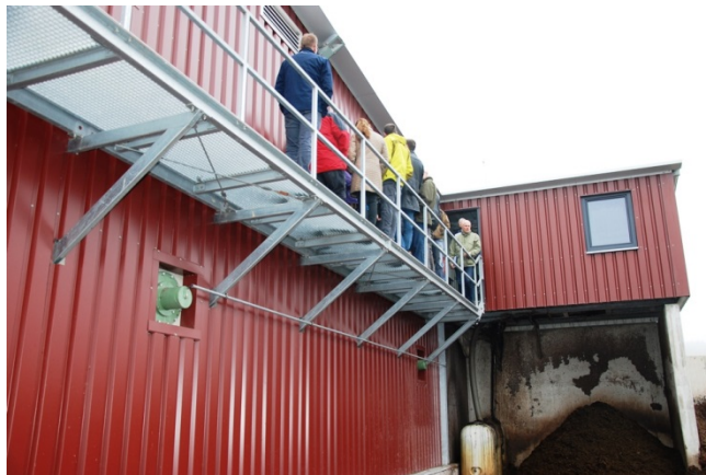
Foto 21: Fremvisning af separator, der sidder i huset øverst til højre. Under gangbroen ses de to grønne lejer til akslerne i plugflow reaktoren.
