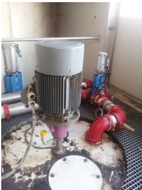
Foto 30: Omrøring i primærreaktoren sker ved pumpning af tynd væske fra tanken og efterfølgende spredning over flydelaget.
