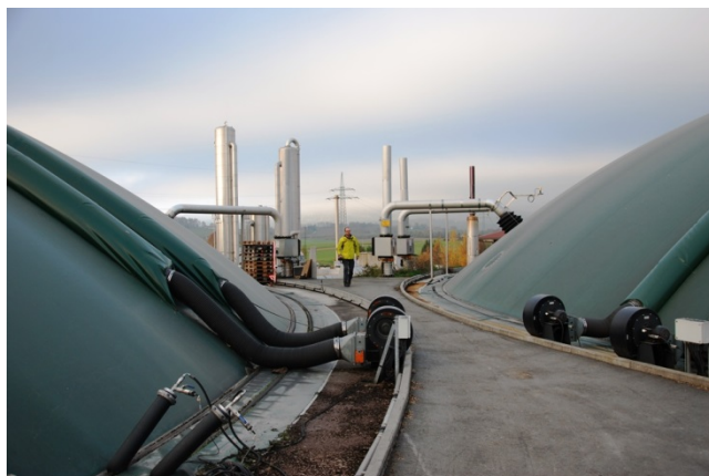
Foto 37: Toppen af begge reaktorer er låst fast i et betondæk. I baggrunden ses opgraderingsstationen..
