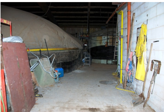
Foto 52: Til venstre ses gaslageret i form af en gassæk, og i baggrundens anes reaktoren.
