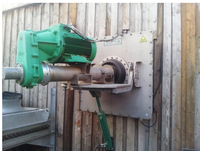
Foto 43: I den sekundære reaktor er biomassen blevet tyndere og det omrøres med en hurtigere propelomrører på et langt skaft monteret gennem reaktorsiden.
